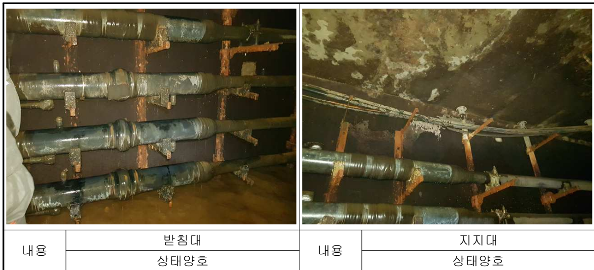
【사진 14.48】 부속 및 부대설비 현황
