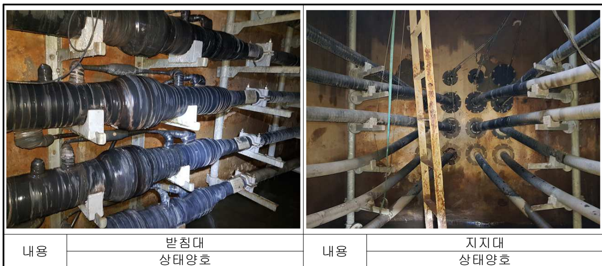
【사진 14.28】 부속 및 부대설비 현황
