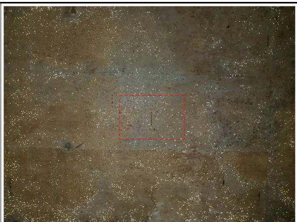
내용 상부슬래브 녹흔적
