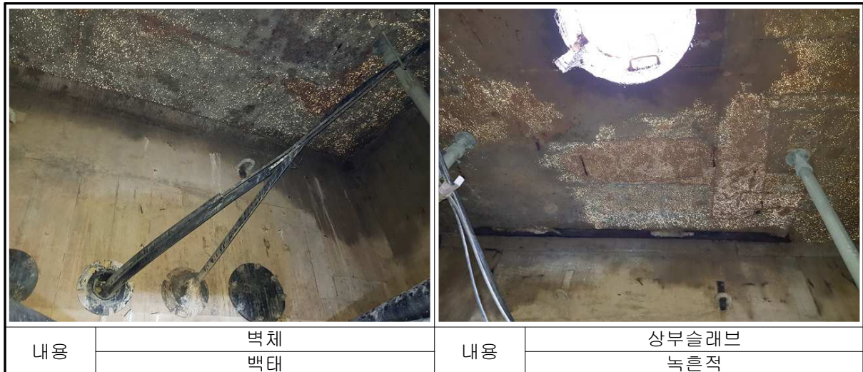
【사진 14.34】 맨홀 내부 주요 손상
