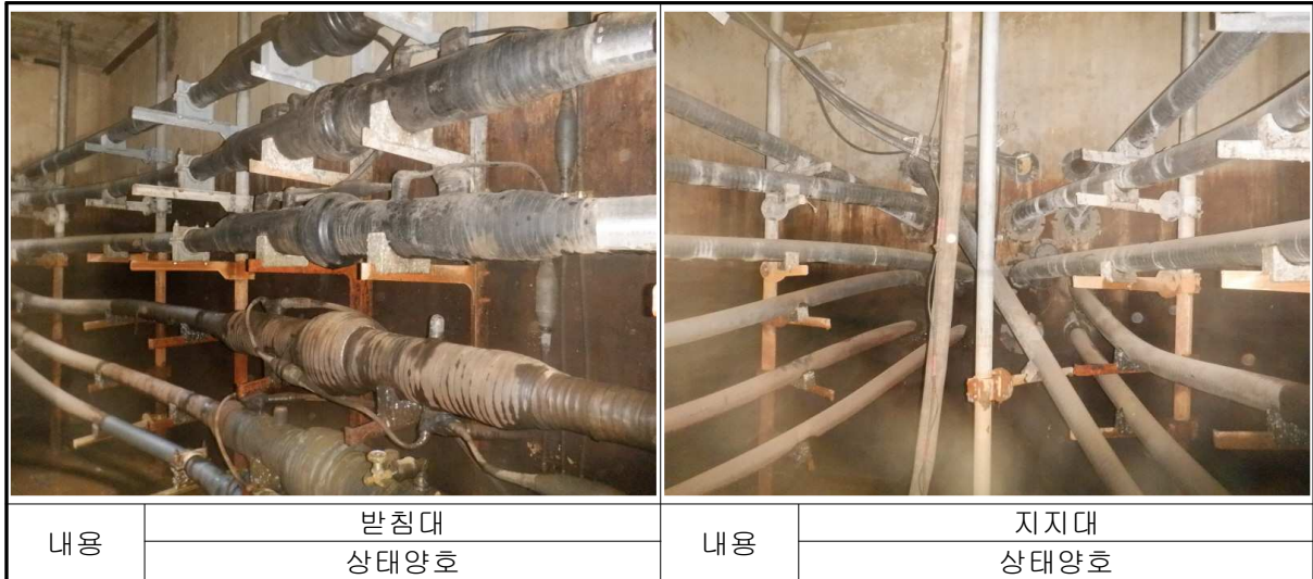
【사진 14.4】 부속 및 부대설비 현황
