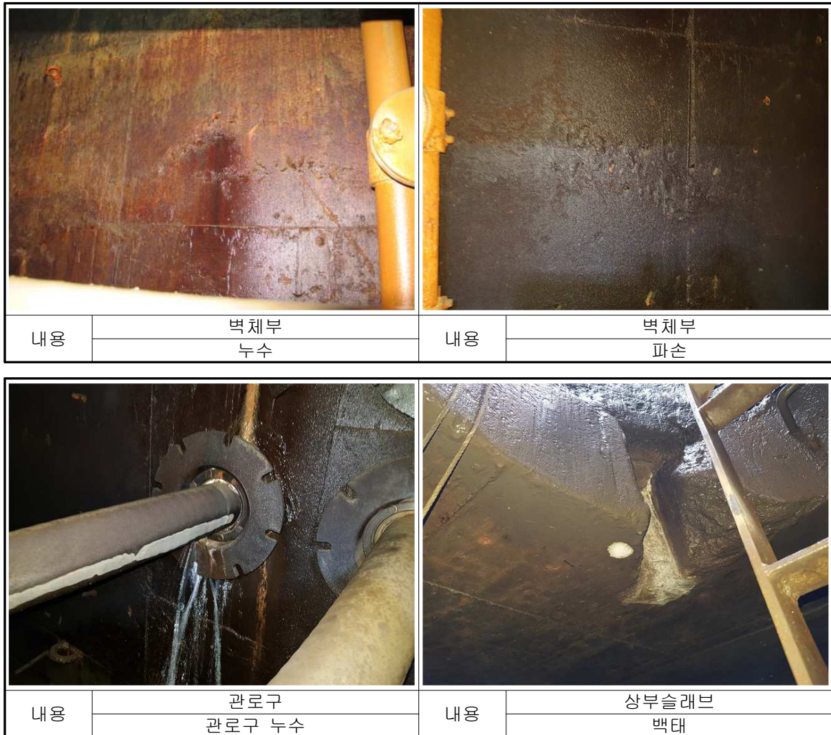
【사진 14.10】 맨홀 내부 주요 손상
