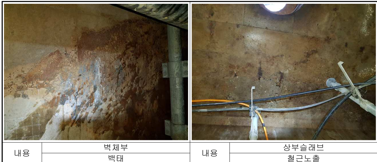
【사진 14.26】 맨홀 내부 주요 손상
