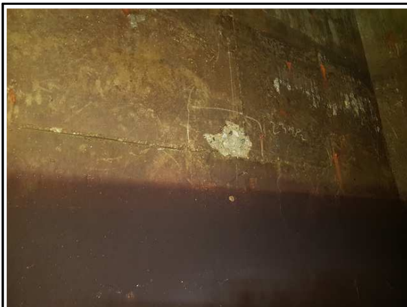
내용 벽체부 파손
