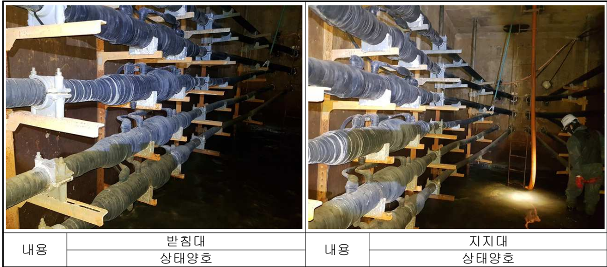
【사진 14.20】 부속 및 부대설비 현황
